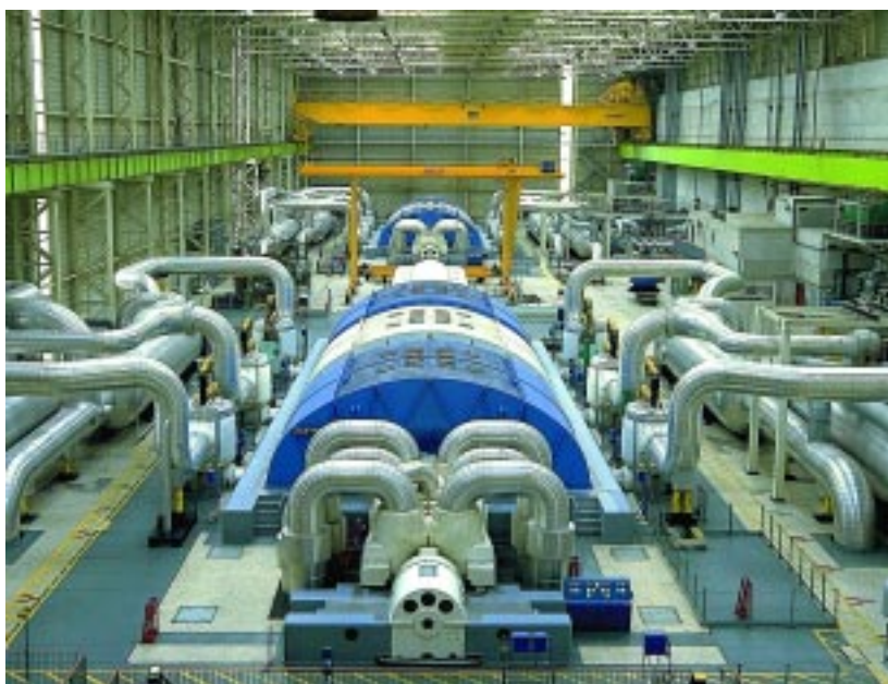
Salle des machines du centre de production nucléaire du Blayais La médiathèque EDF/Marc Morceau
