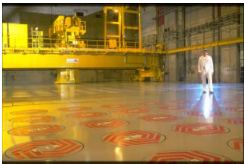
Hall d'entrepasage de l'atelier de vitrification de l'usine de retraitement de La Hague Cogema/Philippe Lesage
